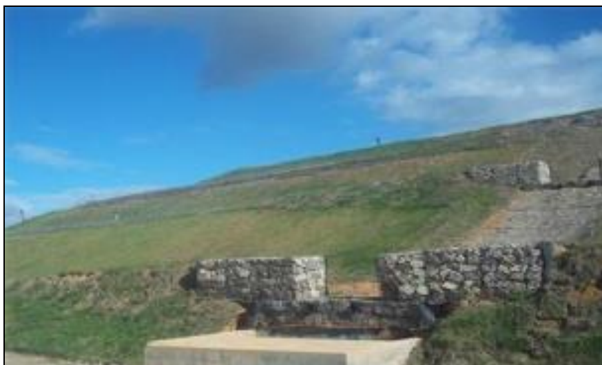
Figura 15 – Estrutura de drenagem de águas pluviais do Aterro Sanitário. Fonte: Andrade (2016).
