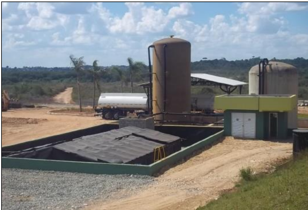
Figura 14 – Tanque Pulmão para Tratamento de Chorume. Fonte: Andrade (2016).
