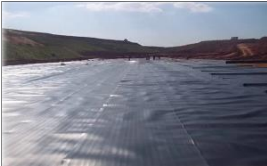
Figura 12 – Impermeabilização de Base com manta de PVC no Aterro Sanitário. Fonte: Andrade (2016).
